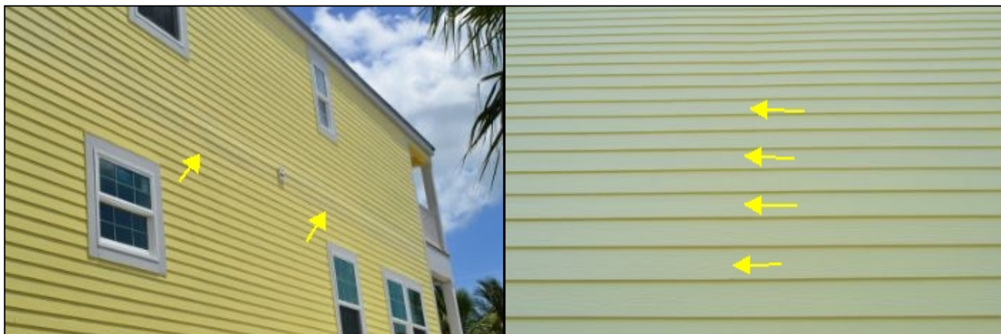
Uneven wall surface
